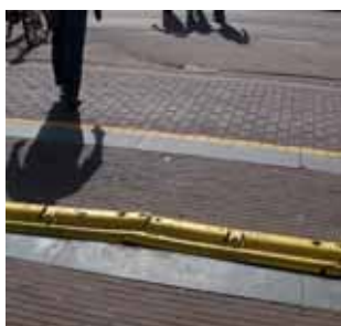
Deze kabelgoot van meer dan 100 mm hoog vormt een obstakel. Hij is wel goed zichtbaar.
